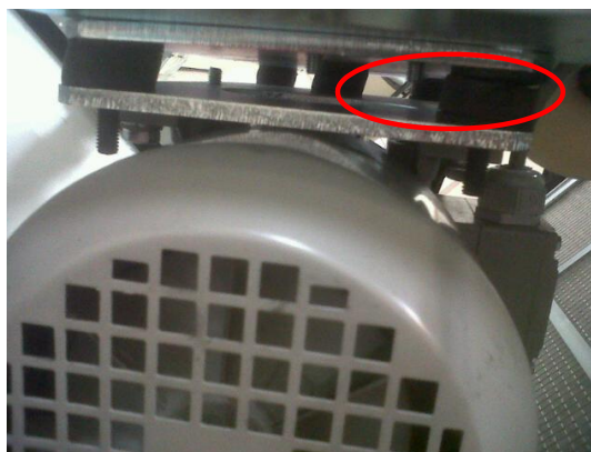
Fig. 1: Exemplo de amortecedor de borracha deteriorado na placa de montagem
