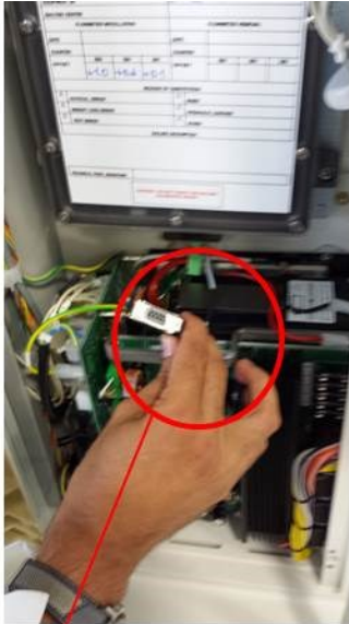
DFL-1 desconectado do sensor do medidor de fluxo de massa
