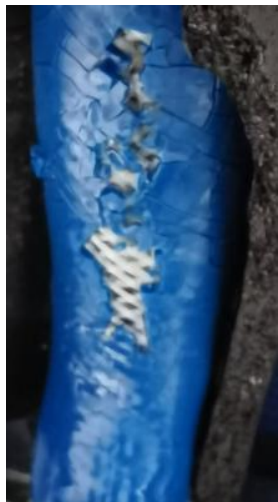
Figura 1: Mangueira de drenagem degradada
