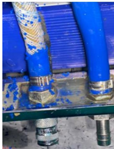
Figura 2: Mangueira de cor azul degradada vs. intacta
