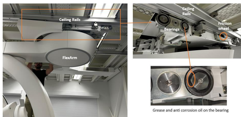
Figura 2. Visão geral dos elementos do suporte FlexArm e identificação do problema
