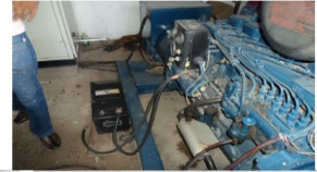
Gerador desligado da função automática, bateria desligada.
