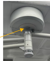
Imagem 1: Componente afetado: Anel de Soffit
